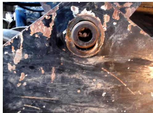
歪んだトラックローラーの軸穴
